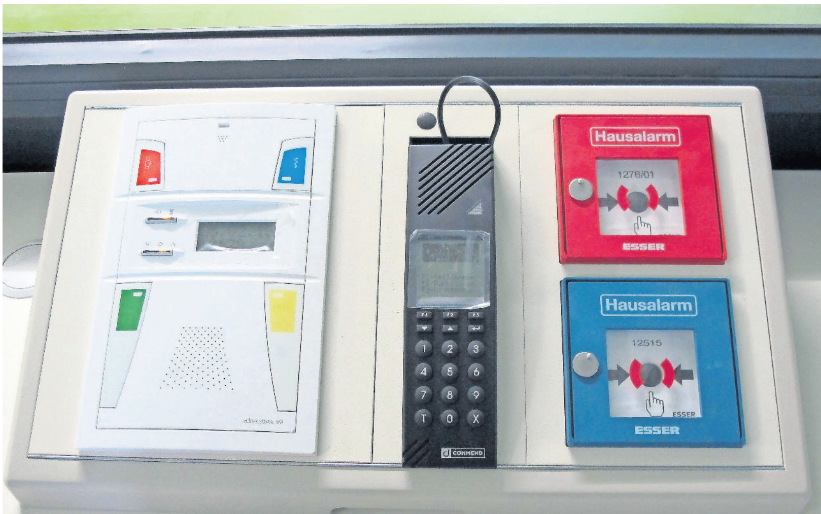
Telefon- und Alarmanlage auf einer der Etagen im Gefängnis Heidering.
